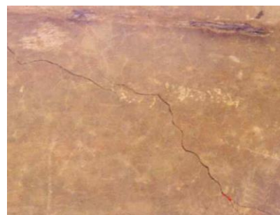
Figura 3-14. . Grieta a cortante en viga principal de concreto reforzado. Espesor de la grieta mayor a 0,6 mm. Regional Boyacá. Fuente: (Muñoz, 2011) h
