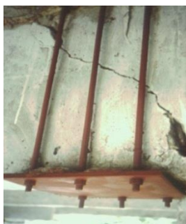
Figura 3-13 Grieta a cortante en viga principal de concreto reforzado, con un espesor mayor de 0,6 mm. Fuente: (Muñoz, 2011) h
