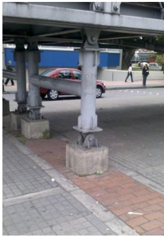
Figura 3 - 40 Ejemplo de pedestal que soporta pila de acero de puentes peatonal. Fuente: (Sandra Suarez, 2010)
