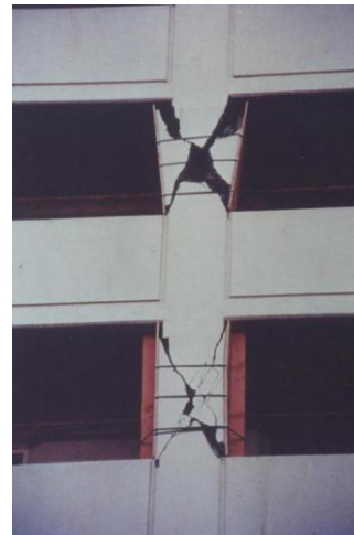
Figura 4-70 Fotos de columnas cortas, cautivas y peligrosas. Fuente: GPT-4.
